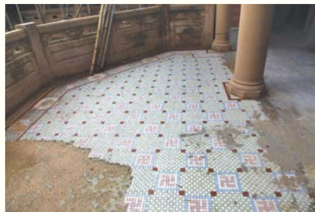
圖 15. 一樓露台馬賽克部分被破壞
