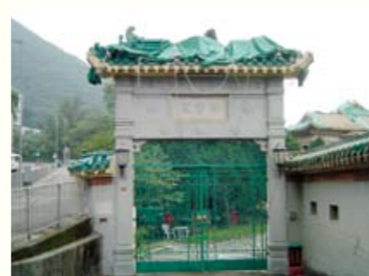
圖 4. 外門樓屋頂被破壞
