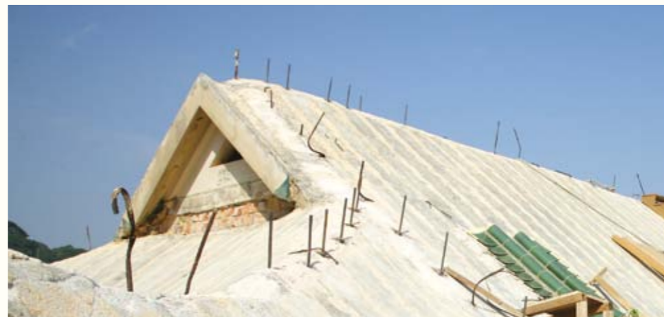
圖 53. 修補前（上圖）及修補中（下圖）的固定瓦脊鐵枝
