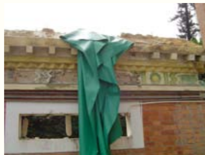
圖 3b. 內圍牆屋頂被破壞
