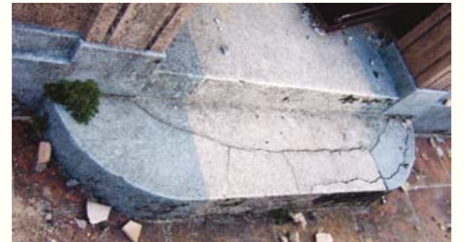
圖 17. 二樓外平台水磨石台階自然裂開
