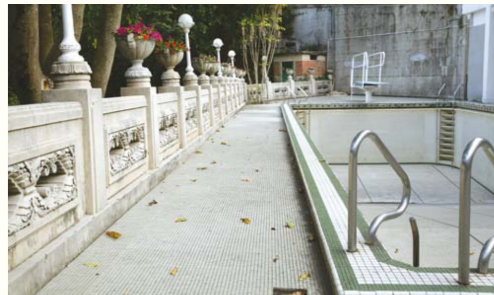
圖 25. 游泳池外側護欄輕微外傾
