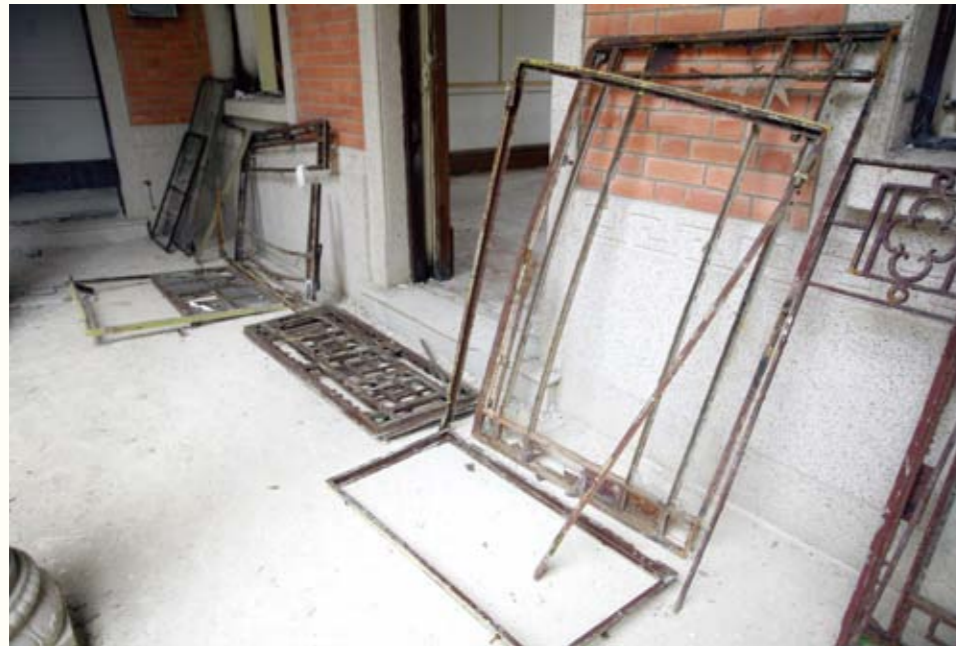
圖 33. 主樓鐵窗全部變成廢鐵
