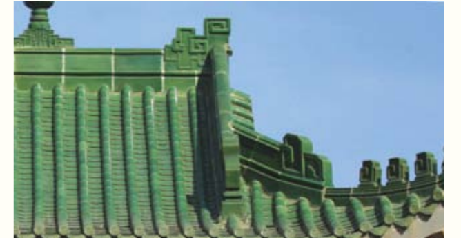
圖 104. 南坡面的垂脊壓筒（原狀做法）
