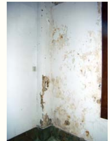
圖 38. 主樓二樓西北牆角出現滲漏
