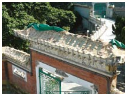
圖 3a. 內門樓屋頂被破壞
