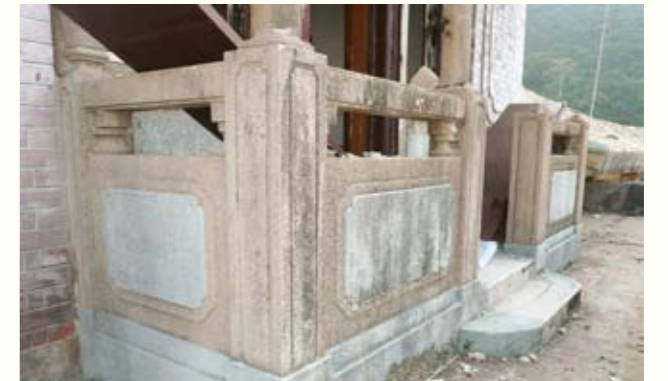
圖 24. 二樓北露台的出口平台護欄被嚴重破壞
