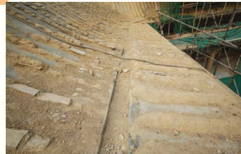
圖 37. 坡屋面截水溝被堵塞
