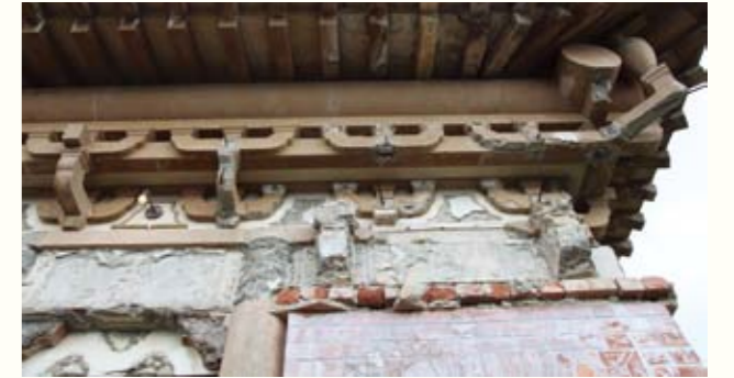
圖 6. 簷下斗拱被破壞
