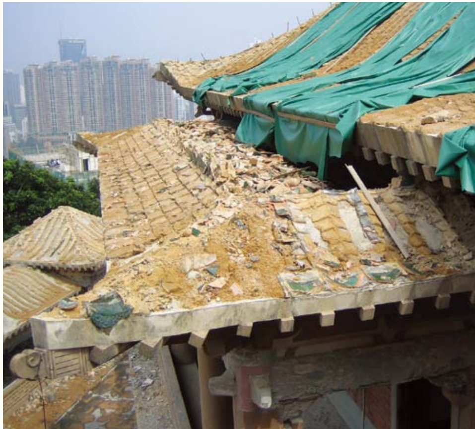
圖 1. 主樓屋頂被破壞
