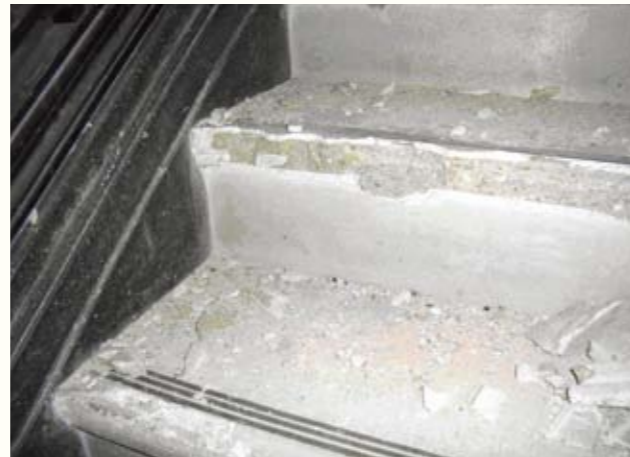
圖 29. 水磨石踏面和踢面全被破壞
