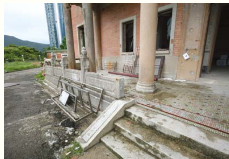
圖 21. 石護欄尋杖和抱鼓垂帶石被破壞
