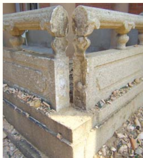
圖 22. 石護欄望柱被破壞
