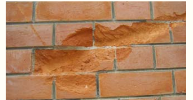
圖 7. 北立面紅磚牆被破壞
