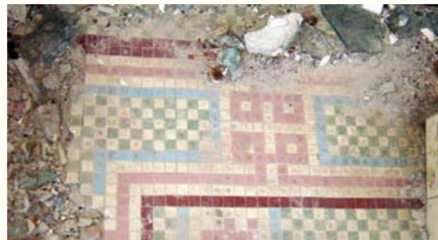
圖 14. 外廊馬賽克地面大部分被破壞
