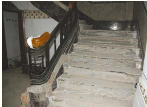
圖 28. 雲石踏面和踢面全被破壞
