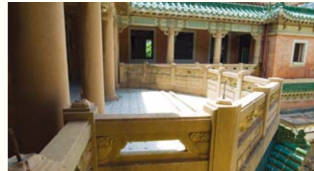
圖 23. 一樓向內院外廊護欄柱頭被破壞，僅存一個完好。
