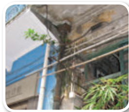
修葺工程前的生鏽排水管。 Rusty drainage pipes before repair.
