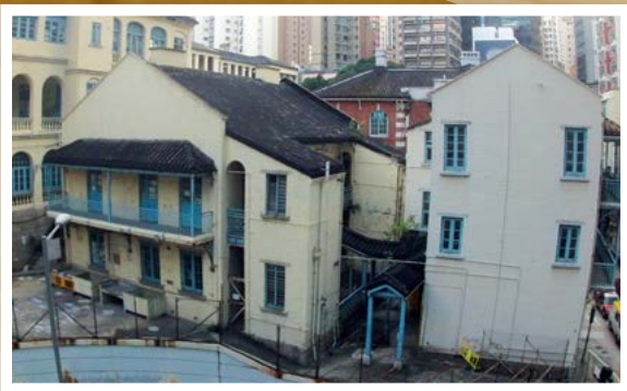
修復前的外牆外貌
