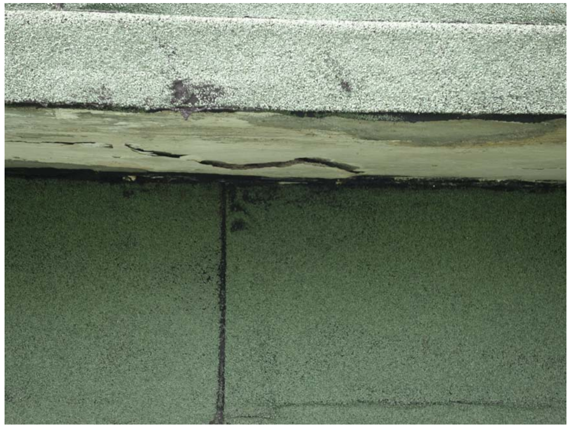
天台簷頂的混凝土剝落
