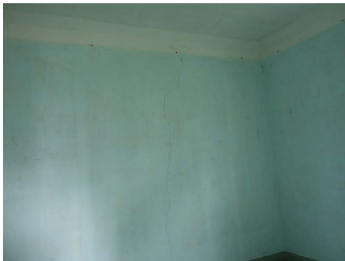
一樓磚牆出現裂紋
