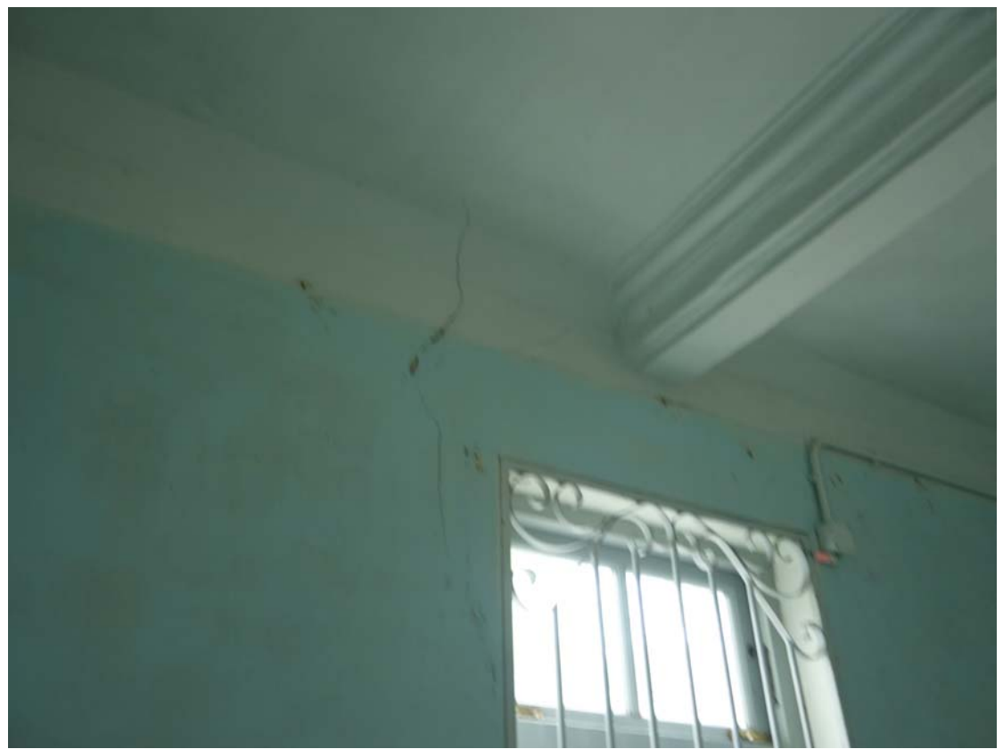
一樓磚牆出現裂紋
