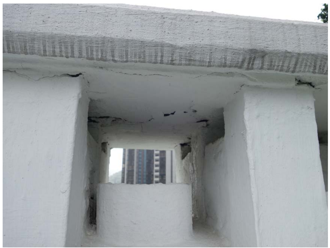
煙囪頂的混凝土剝落
