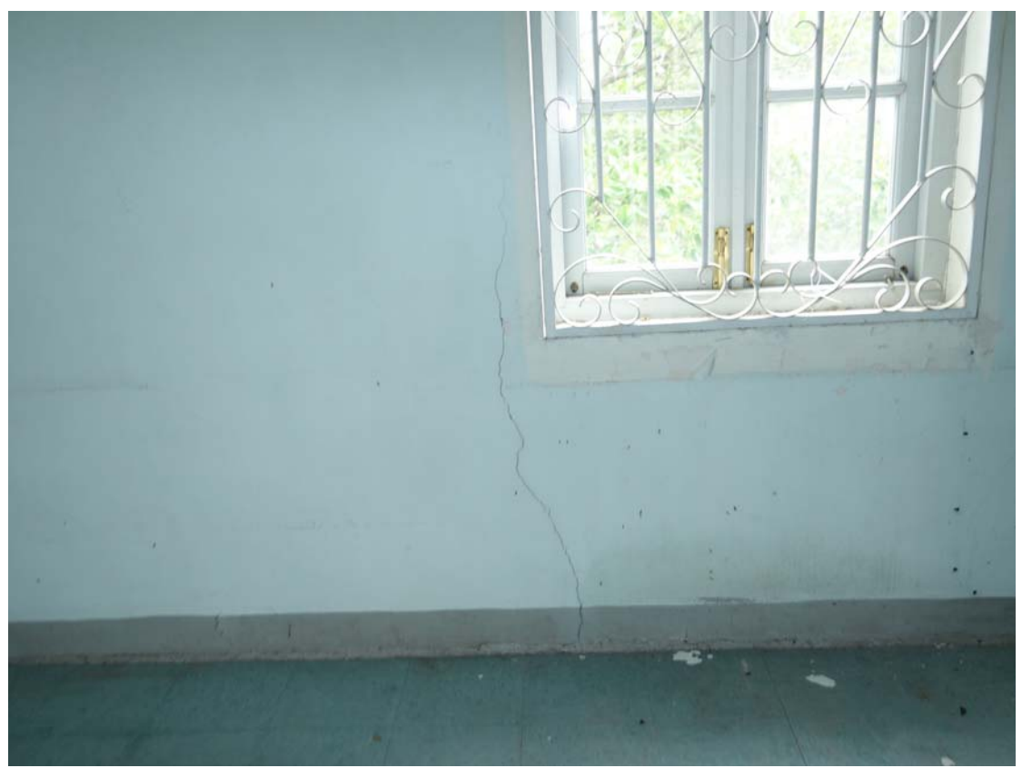
二樓磚牆出現裂紋
