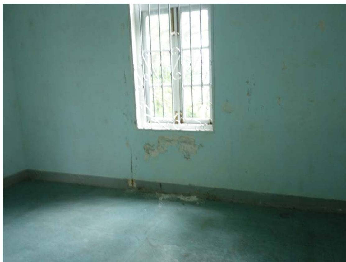
一樓磚牆出現裂紋
