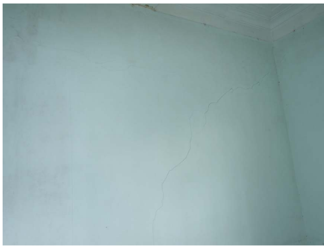
二樓磚牆出現裂紋
