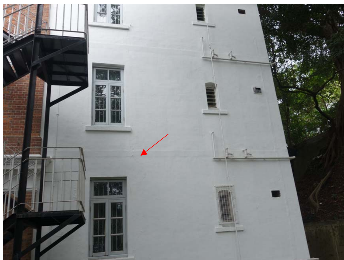
地下至一樓磚牆出現裂紋
