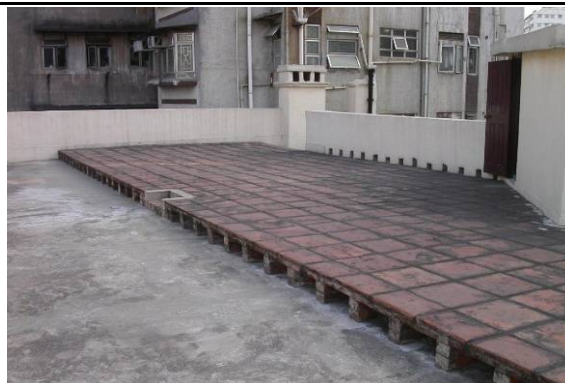
1.10) 主要的鋼筋混凝土天台樓板和其上的廣東大紅磚隔熱屋頂
