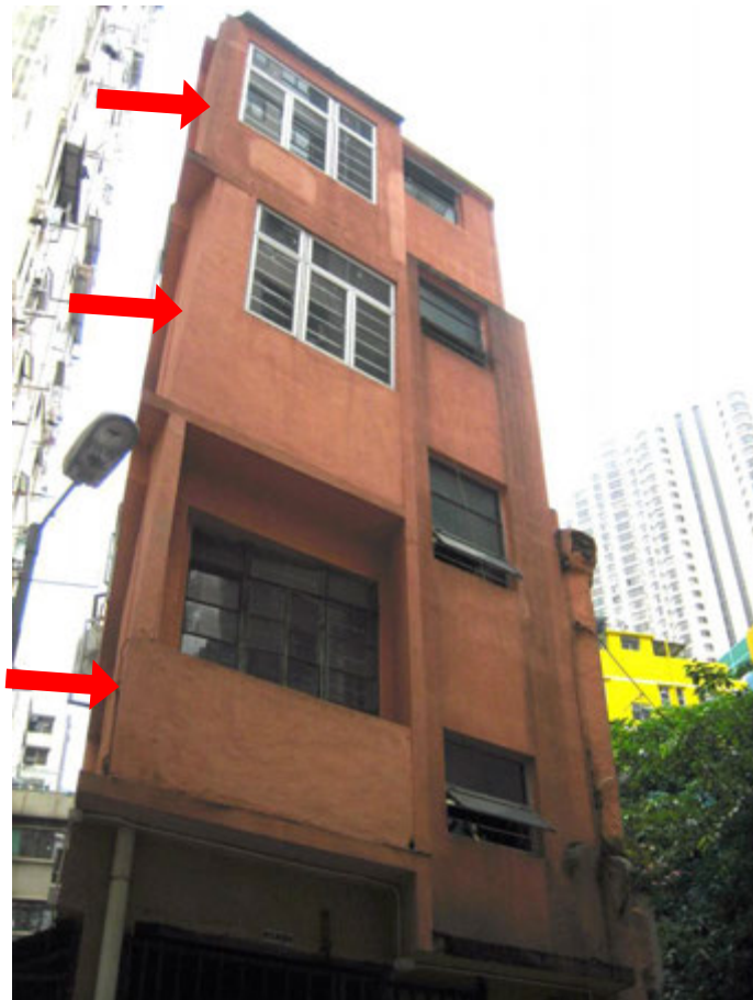
1樓至3樓僭建的陽臺及突出結構（紅色箭咀示）
