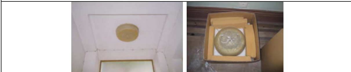
00291 天花照明裝置
