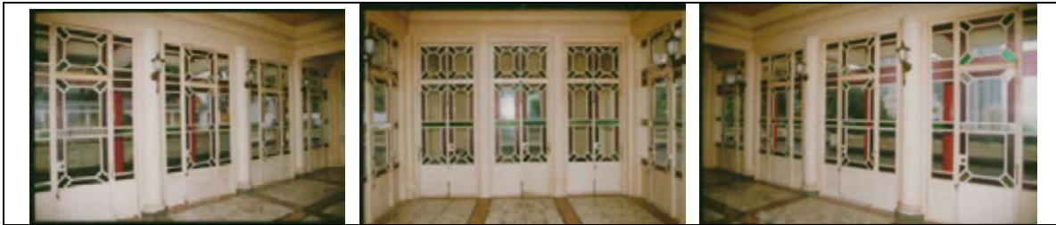
00318 玻璃門窗（位於天台的 T-2 室）
