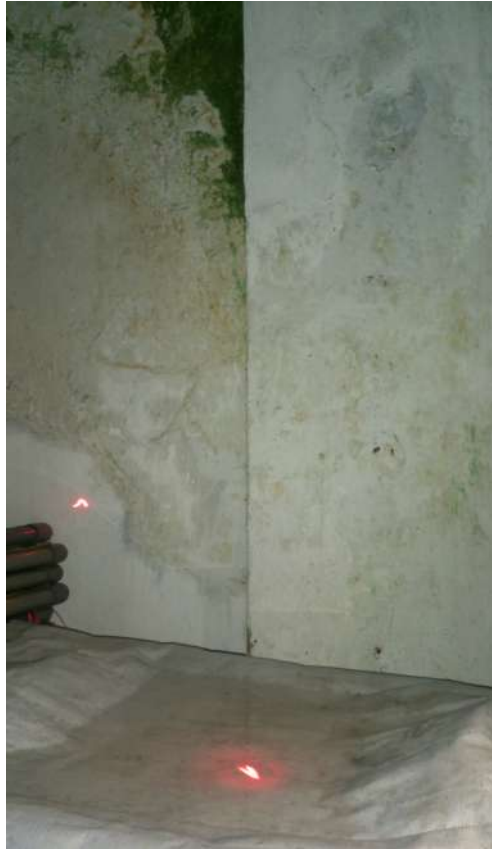
相片 21 屋頂滲漏(實例)
